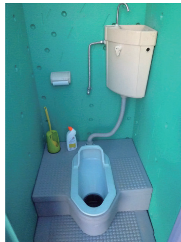
◎トイレ備品設置例
